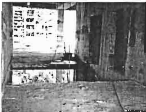
ภาพที่ 9 ช่องเปิดในงานก่อสร้างที่อาจก่อให้เกิดอันตราย
