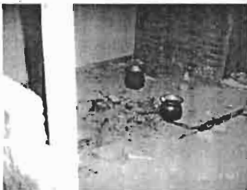
ภาพที่ 11 การก่อไฟบนพื้น ค.ส.ล. อาจทำให้โครงสร้างวิบัติ
