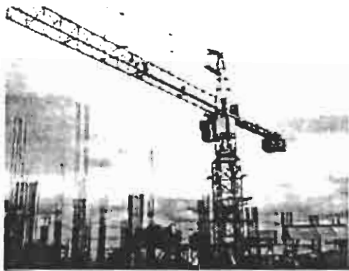
ภาพที่ 7 แสดงหอปั้นจั่นสำหรับงานก่อสร้าง
